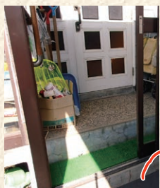
玄関フードの前後にも段差
