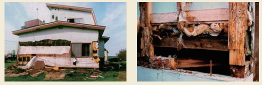
ダンマツ工法による木材腐朽
